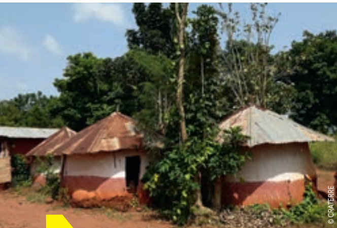
Le temple central du couvent Djénan, avant (à gauche) et après les travaux de restauration (à droite).
